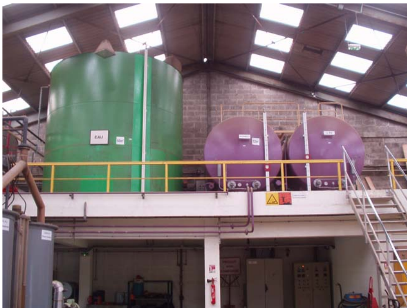
Figure3 : cuves eau, acide
