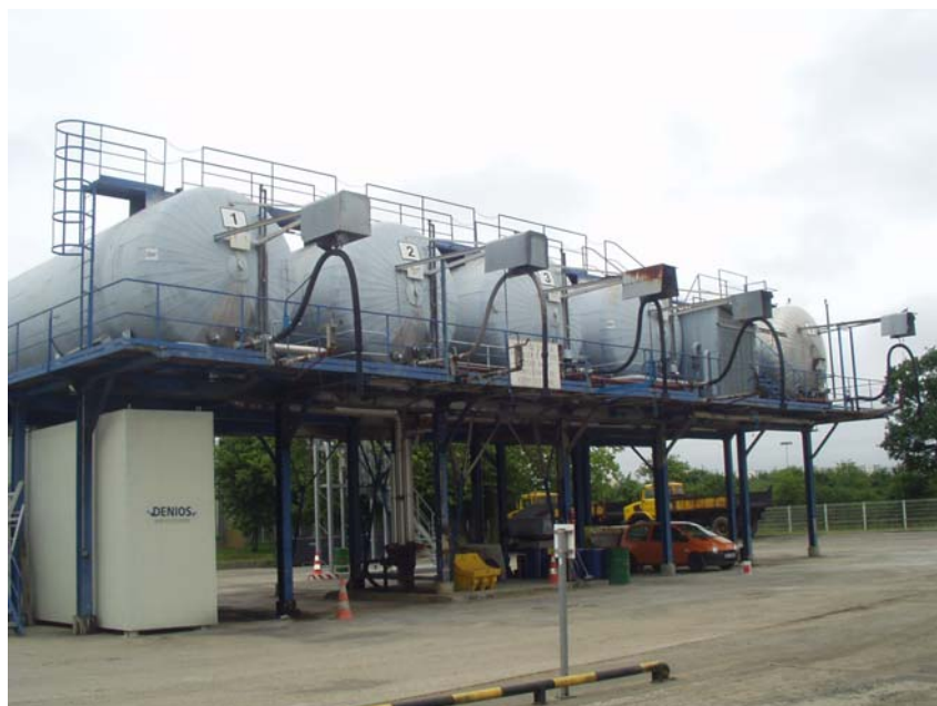
Figure 4 : cuves de stockage de l'émulsion avant chargement
