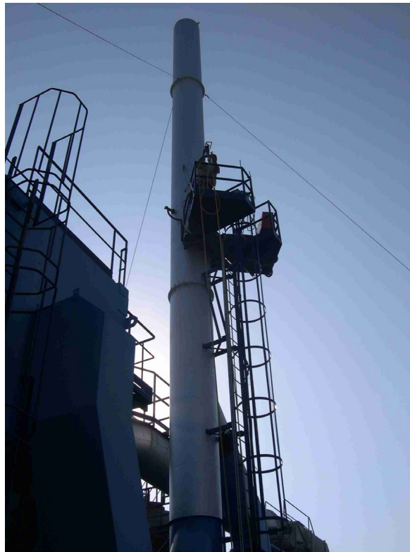
Photo 4 : Cheminée de centrale
